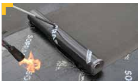
Posa del secondo strato impermeabile, Soprasolar Cap® (dimensione 6 m x 1 m). Applicazione a giunti sfalsati di 25 cm.
