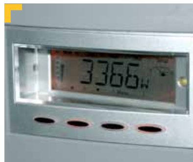
Il monitor sull'inverter permette di verificare in ogni momento la quantità di elettricità prodotta
