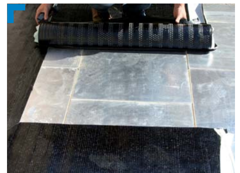
5. Posizionare il telo successivo e ripetere le operazioni. Sovrapposizione laterale 6 cm autoadesiva.
